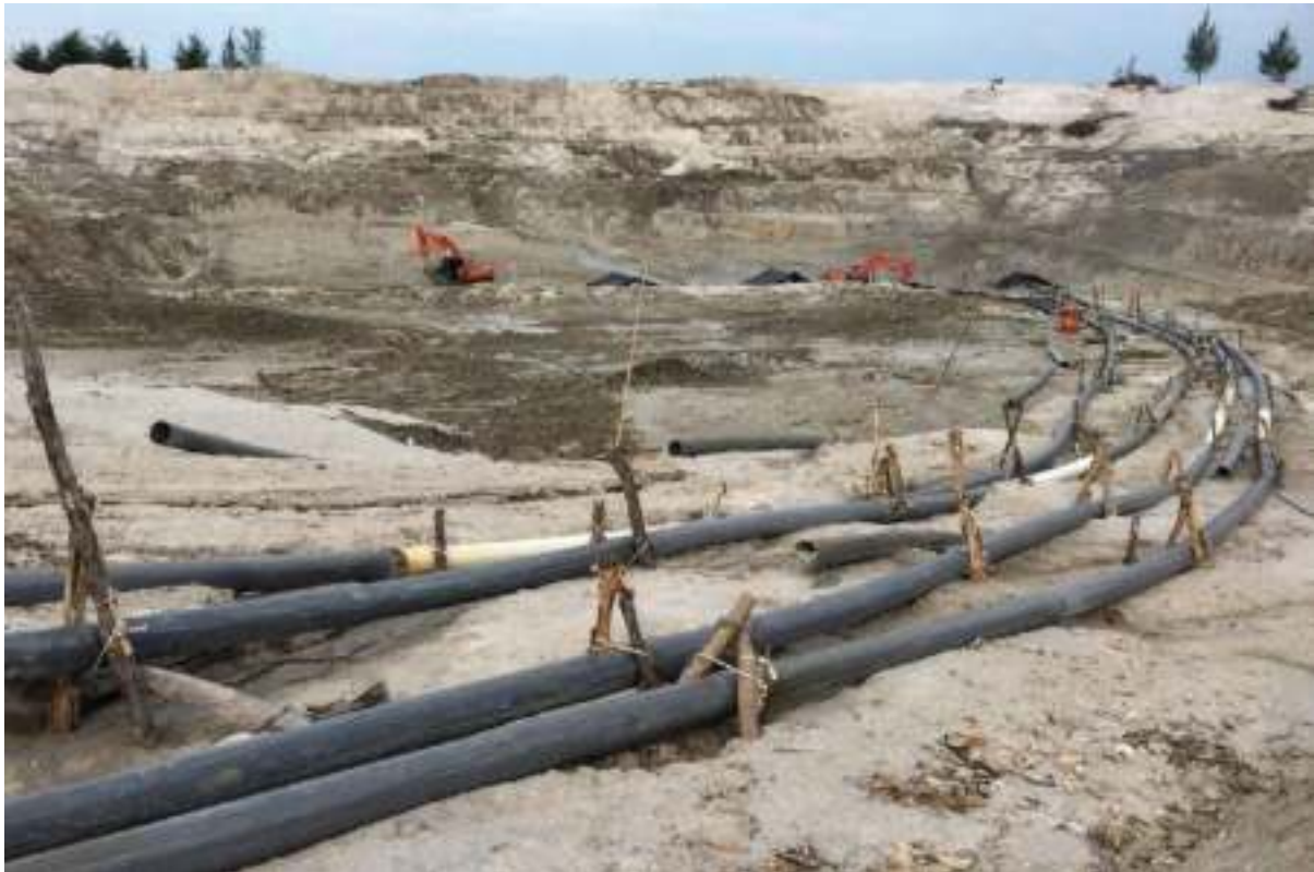
Pipa yang menghubungkan pompa penyedot dengan sakan. (Indah Suci Safitri)
