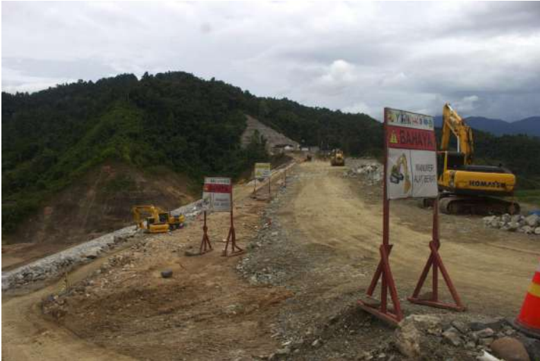
Keterangan foto: Aktivitas penyusunan bongkahan batuan untuk pengecoran Bendungan, Senin 1 Desember 2025 (Foto: Fara)
